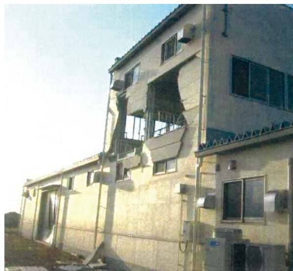
写真-3 被災した原町国道維持出張所 （出典：磐城国道事務所資料）
