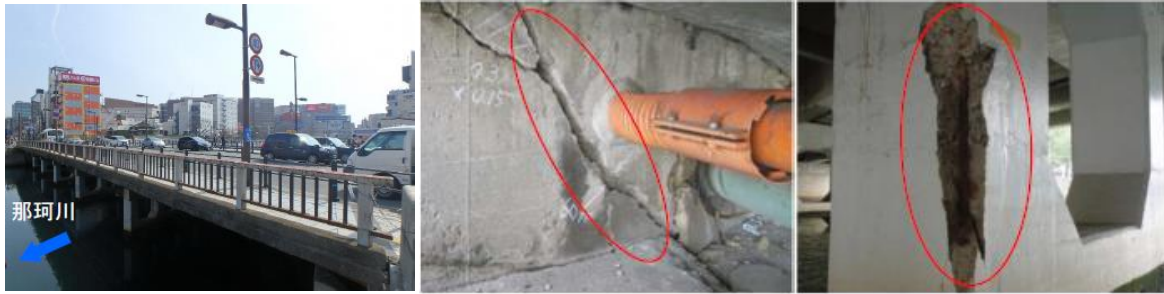
写真-2 春吉橋の老朽化の状況
