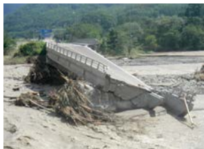
写真-3 千呂露橋落橋 （図-2の①）
