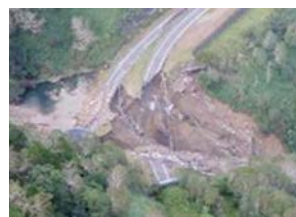
帯広側8合目付近盛土崩壊 (左図の 38)
