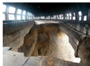
三国の沢覆道損傷 (左図の 29)
