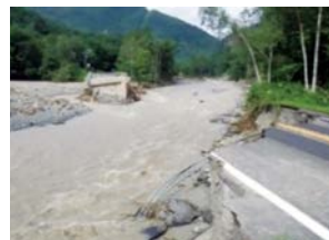
岩瀬橋落橋 (左図の 7)
