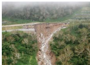
写真-4 清水側7合目盛土崩壊 （図-2の④2）
