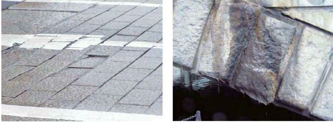
写真-3 損傷状況（橋梁表面のひび割れ、橋梁裏面の石灰分しみ出し）
