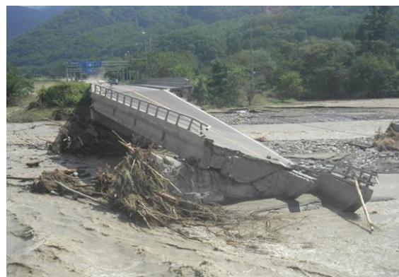
写真-3 千呂露橋落橋 (出典:国土交通省北海道開発局資料)
