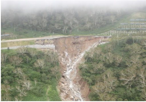
写真－4 清水側7合目盛土崩壊 (出典:国土交通省北海道開発局資料)
