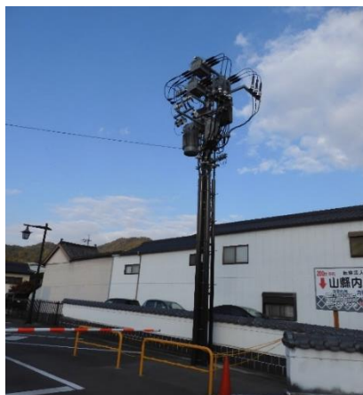
【配置場所を工夫した変圧器】
